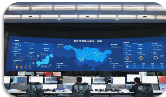
水风光一体化集中调控系统
