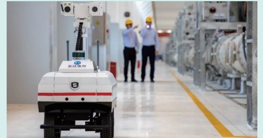
巡检机器人“小白”，自动甄别、精准预警，及时消除风险隐患
