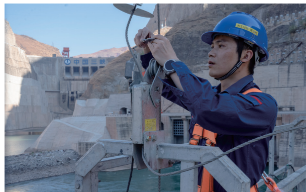
开展电站设备检查测量
